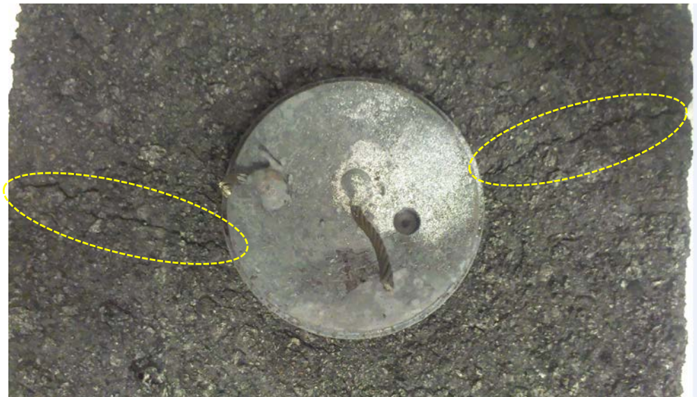
Figure 3-17: Fissuration observée après expérimentation (test #4)
