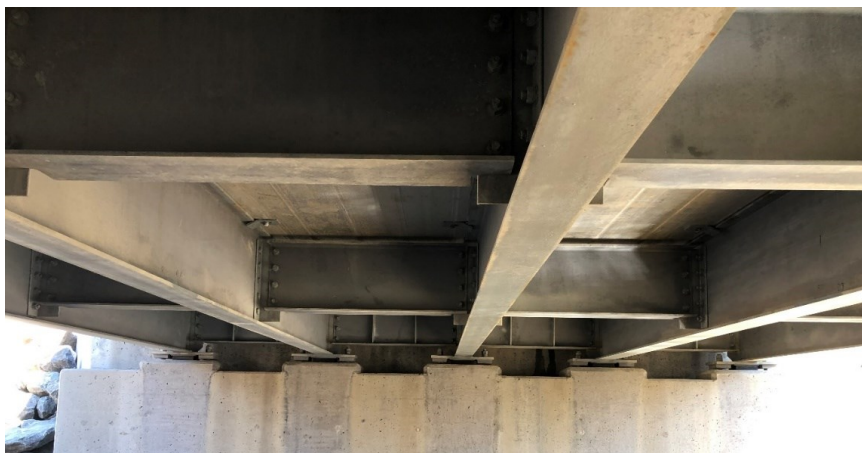
Figure 6-5 : Vue des poutres dessous du pont, poutre principale, diaphragme et appareil d'appuis
