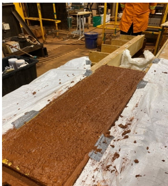
Figure 4.25 : Surface arasée du béton géopolymère du banc de parc
