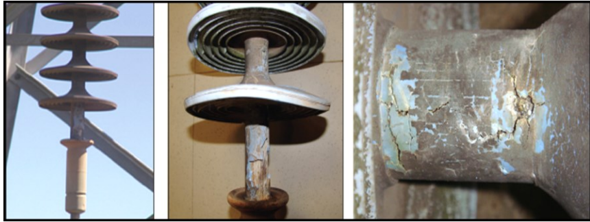
Figure 9 : Dégradation d'un isolateur composite installé sur une ligne HT 400 kV [62].
