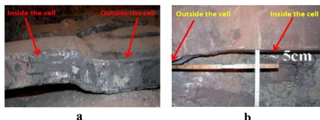
Figure 1-6 : Déformation de la barre collectrice; a: barre collectrice déformée; b: mesure de la barre collectrice déformée après la durée de vie [5]
