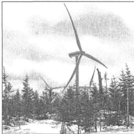
Figure 5-1: Éolienne Vestas 1.8 MW installée à Murdochville.
