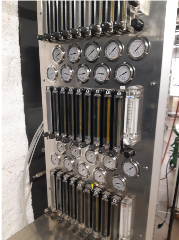
Figure 2.7: Panneau de commande des rampes de gicleurs de la soufflerie réfrigérée givrante du LIMA
