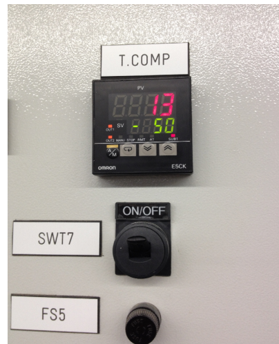
(b) Contrôle de la température des compresseurs
