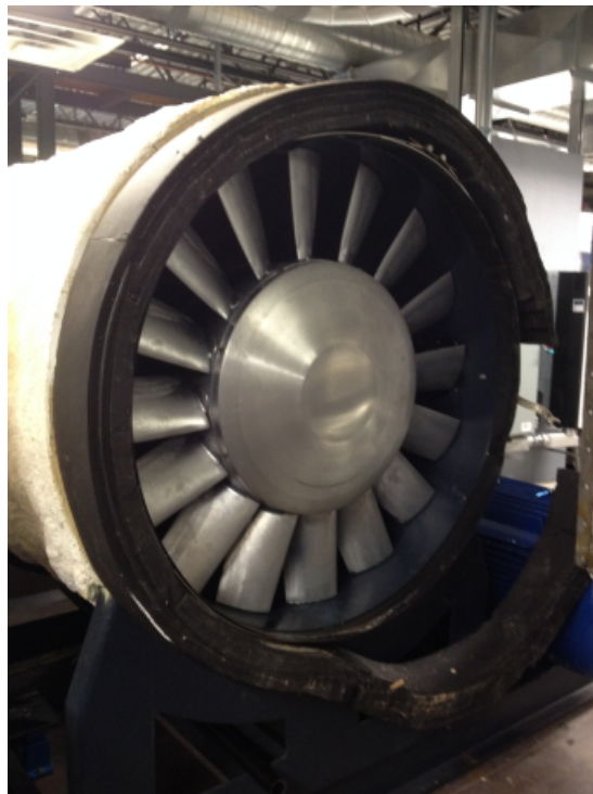
Figure 2.3: Ventilateur de la soufflerie réfrigérée givrante du LIMA
