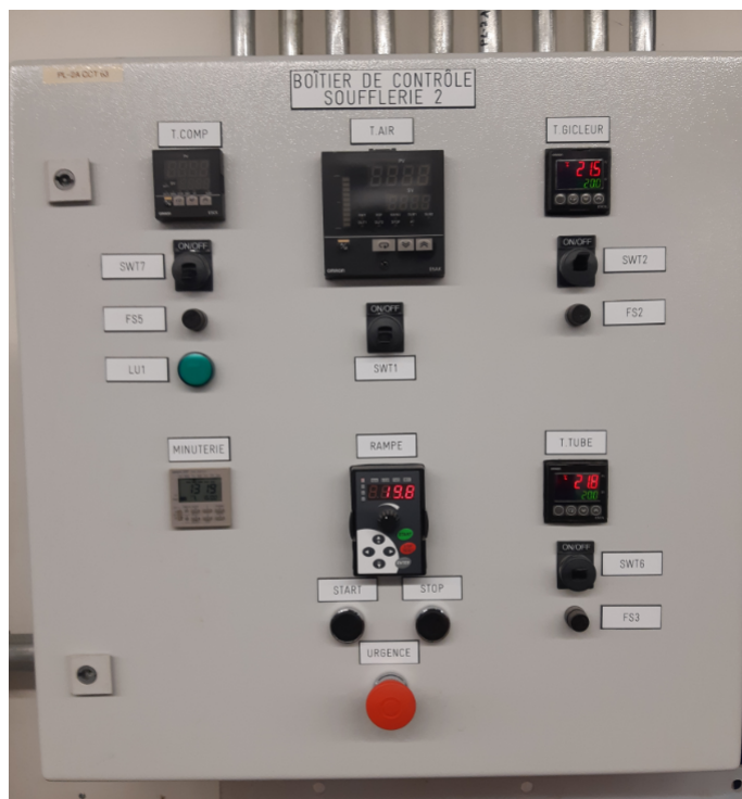
Figure 2.5: Boîtier de contrôle de la température de la soufflerie réfrigérée givrante du LIMA
